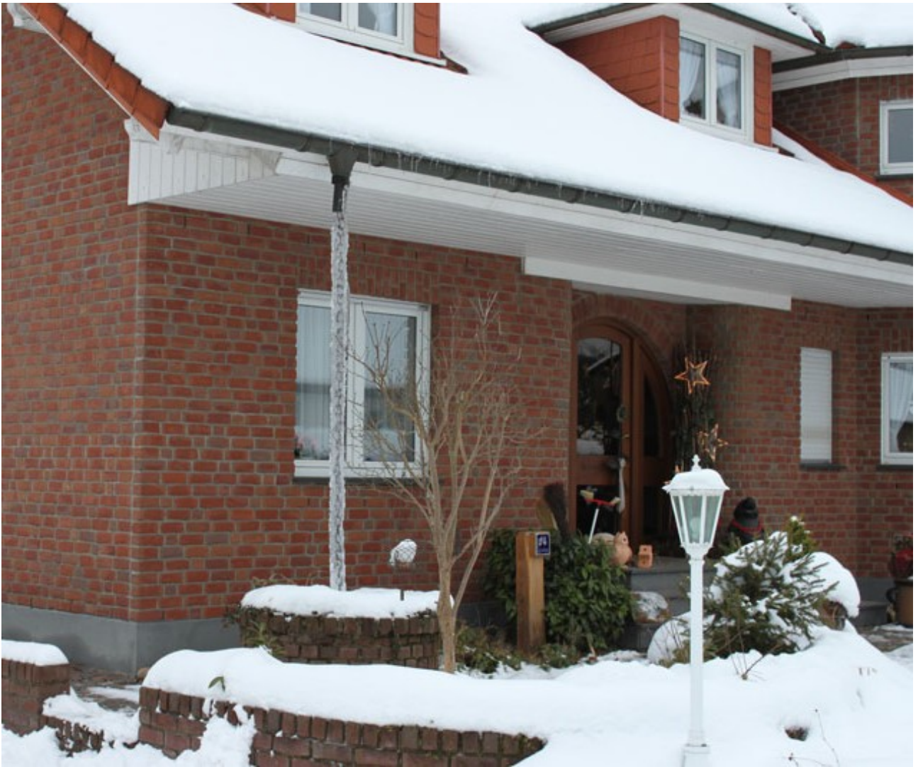
Das ist unser Pirlipause . Eis an der Wasserablauf-Kette der Dachrinne.
